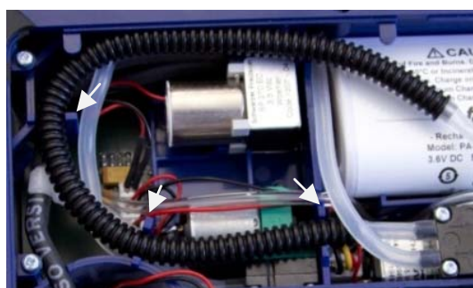
Ill. 66: Tuyau ondulé positionné correctement; Crochets de guidage indiqués par la flèche
