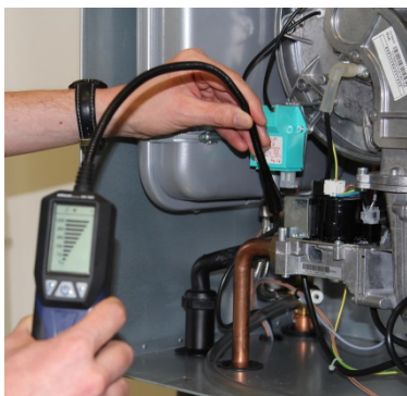
Abb. 5: Der Gasspürer zeigt ein deutliches Signal, wenn er an den leicht geöffneten Messstutzen gehalten wird.
